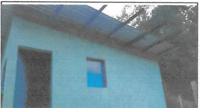
Foto 4: Entabicado lado arriba de la lamina de la cocina.
